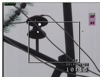
Рис. 1. Дефектный опорный изолятор 110 кВ, трещина фарфора.
